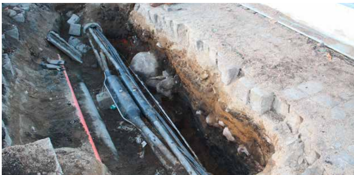
Fig. 45: Schaktet för el- telereparation i område 10. Orörda lager och konstruktioner fanns till höger i bild, i schaktets norra sida. Foto från sydöst.
