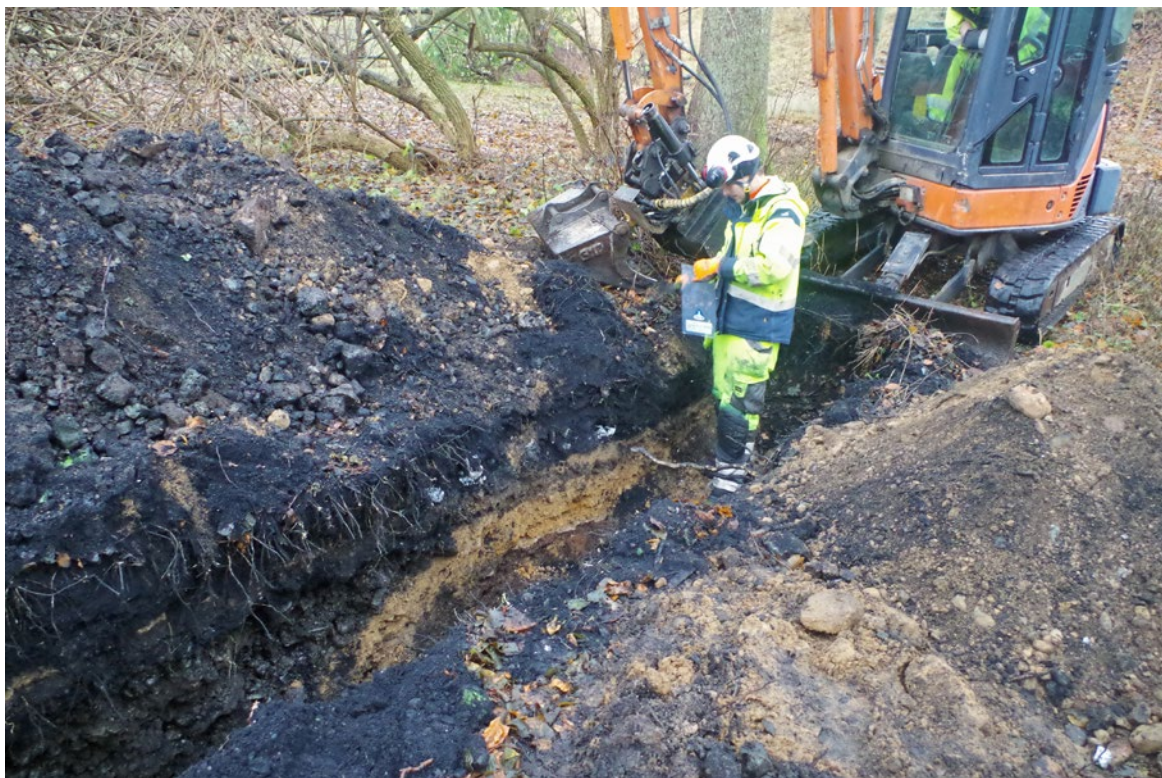
Figur 19. I schakt 8 fanns påförda lager av glasbruksavfall och slagg. Det ljusare lagret till höger i bild är ett påfört gruslager ovanpå en äldre strandzon. Foto från öster.
