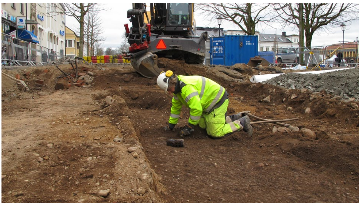
Figur 83. Här rensas den medeltida gatunivån fram med sin gatubeläggning av småsten, så kallad knaddersten. Foto från nordöst.
