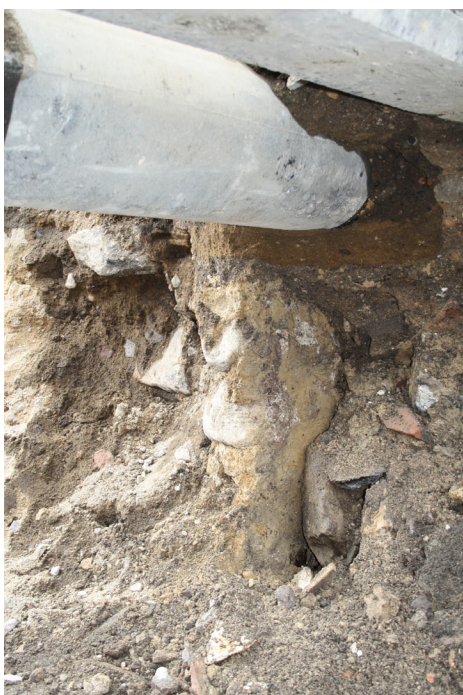
Figur 23: I den norra delen av källaren A1016 fanns delar av det ovanliggande husets dagermur bevarad med tegel satt i murbruk, A1059.
