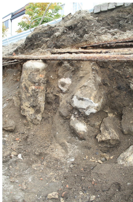
Figur 25: Det andra stenfundamentet i källaren A50136, A1115, framträdde i schaktväggens östra sida. Foto från SV.
