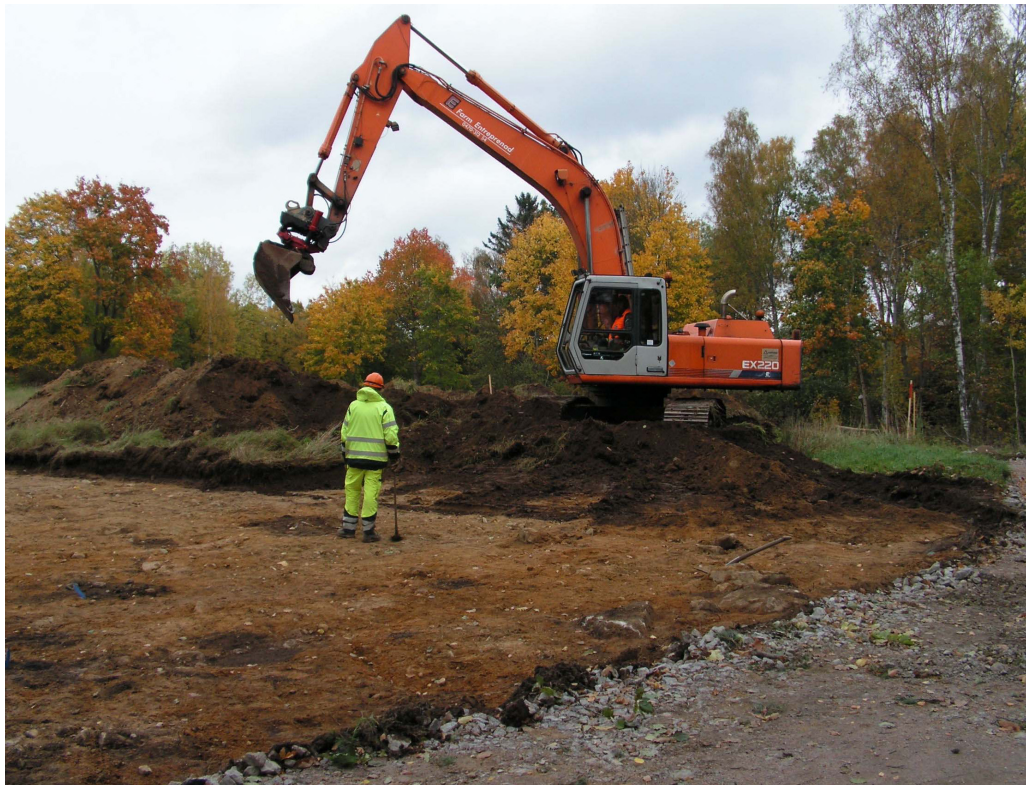
Figur 4. Avbaning av matjorden med grävmaskin vid den kompletterande undersökningen i oktober. Ytan för cykelvägen till höger och området för den provisoriska vändplatsen till vänster i bild.
