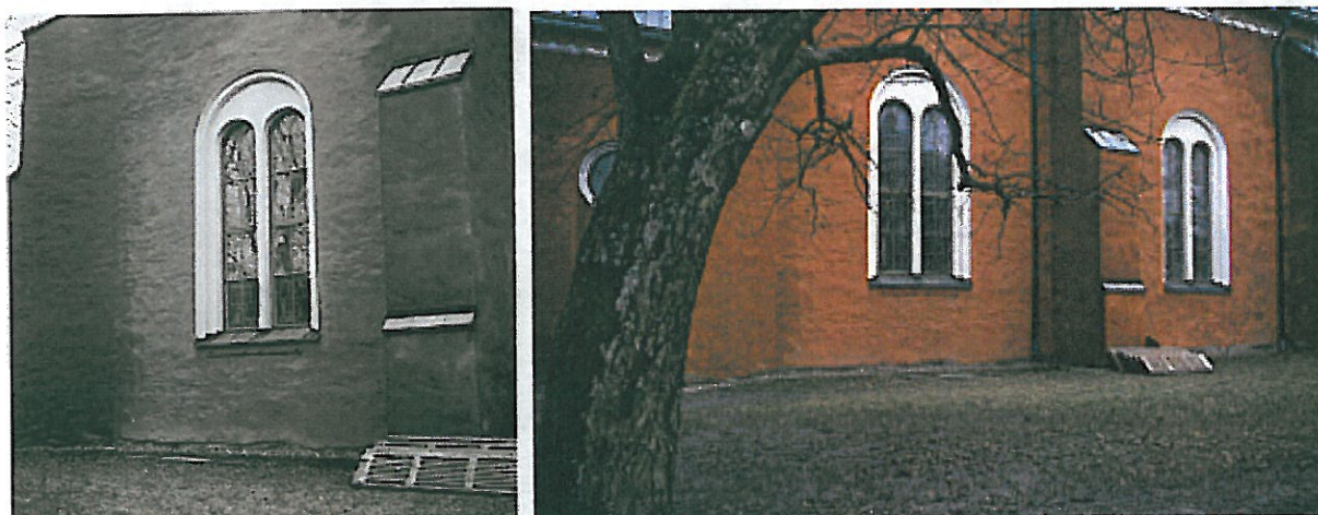
Domkyrkans nordöstra travé exteriört före ingreppet
